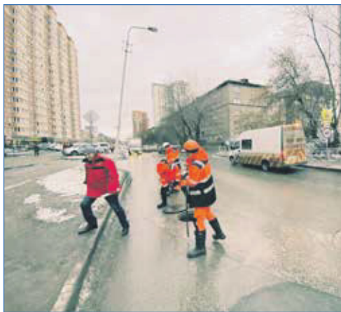
Работающая ливневая канализация от пересечения улиц Перевозчикова и Дачная до Северной
