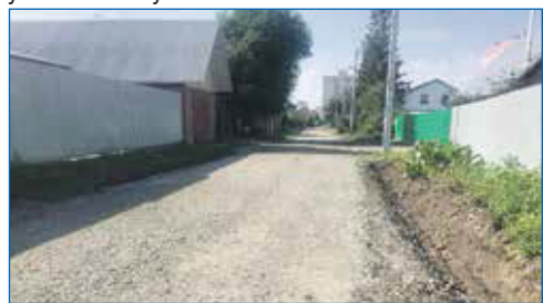
Отсыпка, 8 Бронный переулок. Весной здесь вместо дорог были реки
