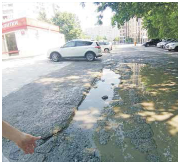
Разбитые дороги нуждаются в ремонте
