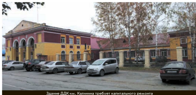
Здание ДДК им. Калинина требует капитального ремонта
