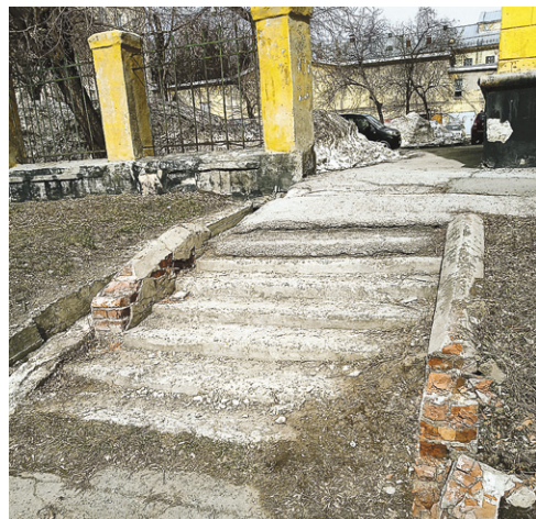
Один из примеров лестницы, требующей ремонта.
