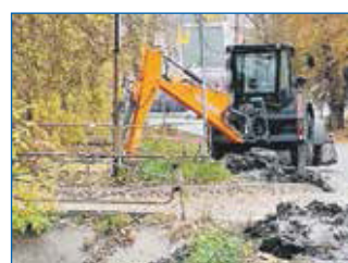
Отвод воды с проезжей части на ул. Пархоменко
